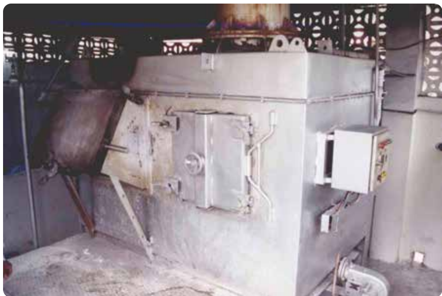
图39: 巴基斯坦某个小型医疗废弃物焚烧设施的双室炉。
