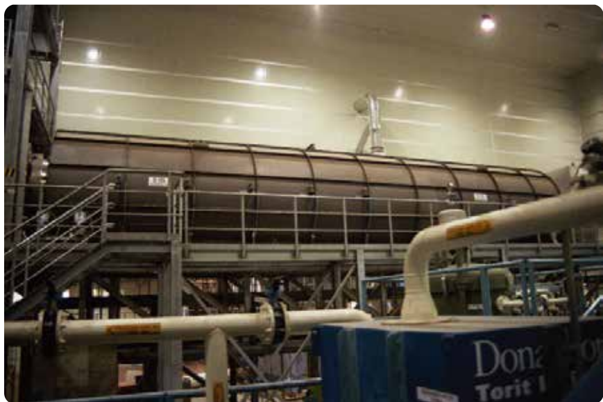
图30: 捷克斯国内拉托维采 (Neratovice) Spolana工厂正在运行的间接热解吸装置。摄影: Arnika协会的Jindrich Petrlík, 2006年2月。
